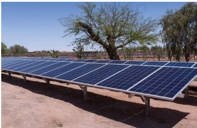
Die Anlage ist leicht zu warten und wird kontinuierlich fernüberwacht. – La instalación cuenta con un mantenimiento sencillo y puede ser monitorizada a distancia de forma continua.
