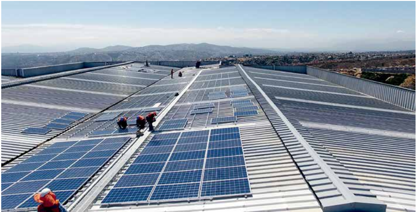
Dach der neuen Logistikhalle von RHONA S.A. während der Installationsphase – Techumbre del nuevo salón de logística de RHONA S.A. durante la fase de instalación
