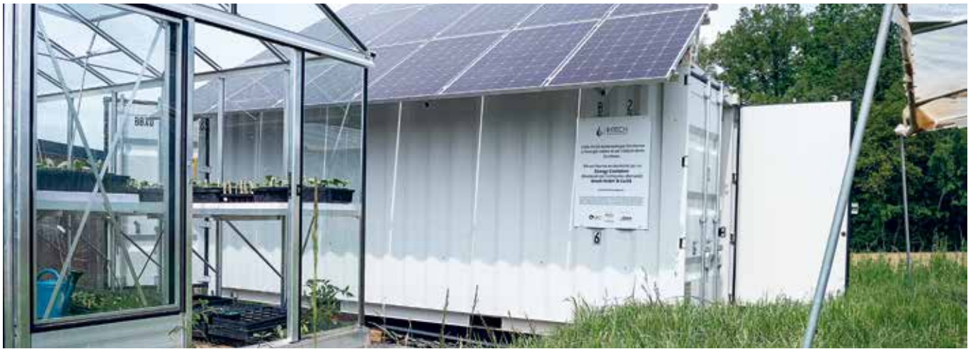
Anlagencontainer mit Modulen für die Versorgung des Gewächshauses – Conteneur d'énergie et modules photovoltaïques pour l'alimentation de la serre.
