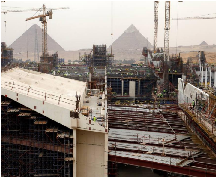
Abb. 22: Ansicht von der Baustelle (Dachkonstruktion) des „Grand Egyptian Museum“ [ http://www.gem.gov.eg/ ] – im Hintergrund die Pyramiden von Gizeh (Stand 30.04.2015)
