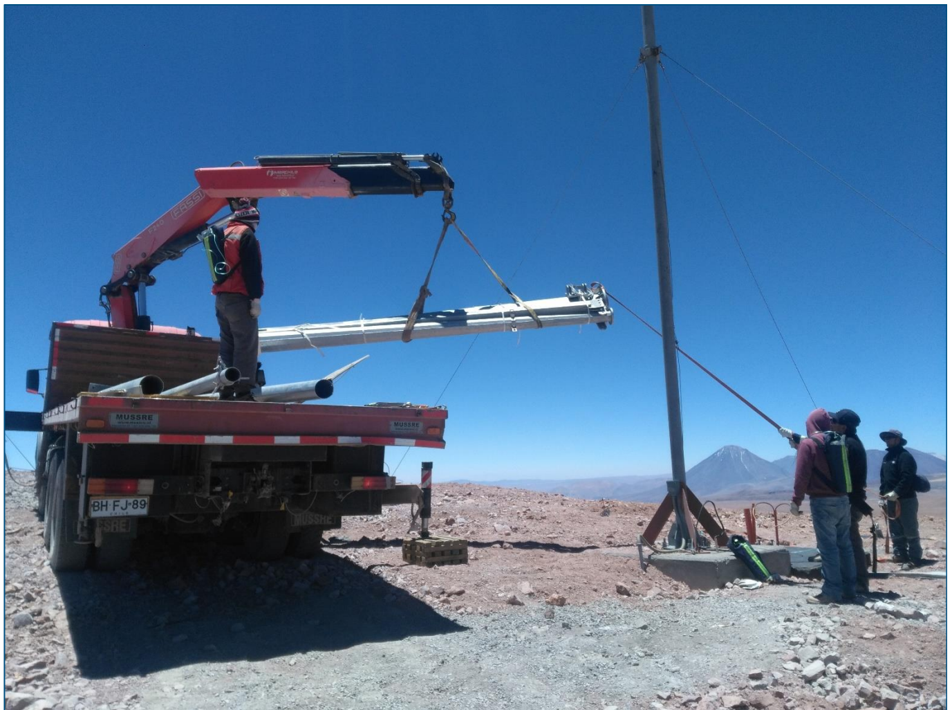
Abbildung 32: Aufbau einer Kleinwindanlage für die europäische Südsternwarte ESO durch die Firma Vivest Energía
