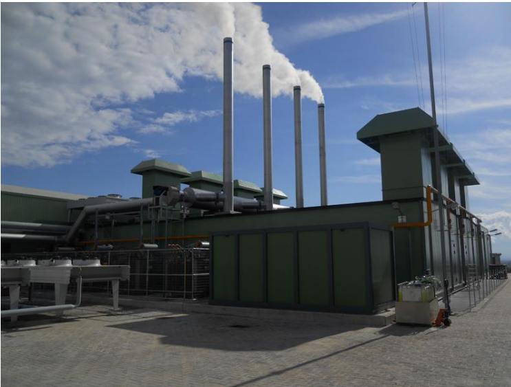
Abbildung 38: Kraft-Wärme-Kopplungs-Anlage auf dem Gelände der Wonderplant S.A.
