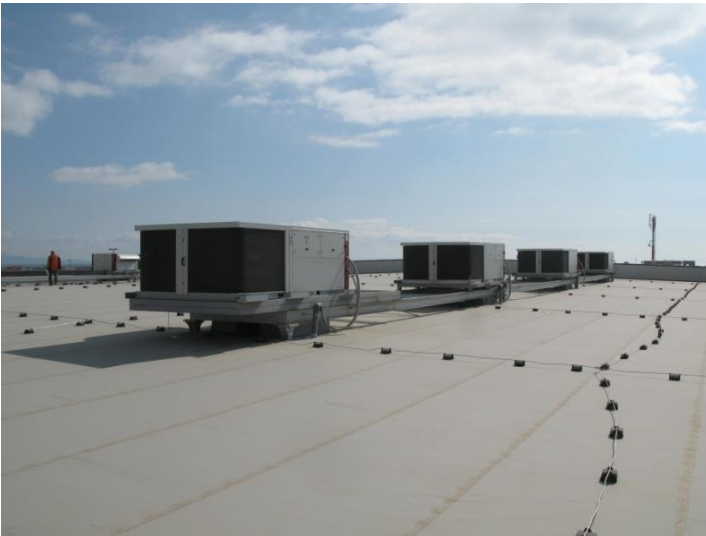
Abbildung 31: Klimaanlage auf dem Dach eines der Supermärkte
