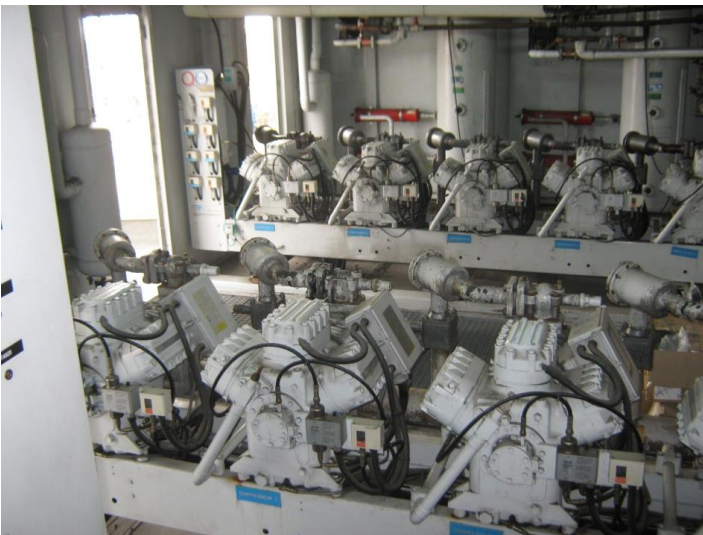
Abbildung 32: Kühleinheit in einem der Supermärkte
