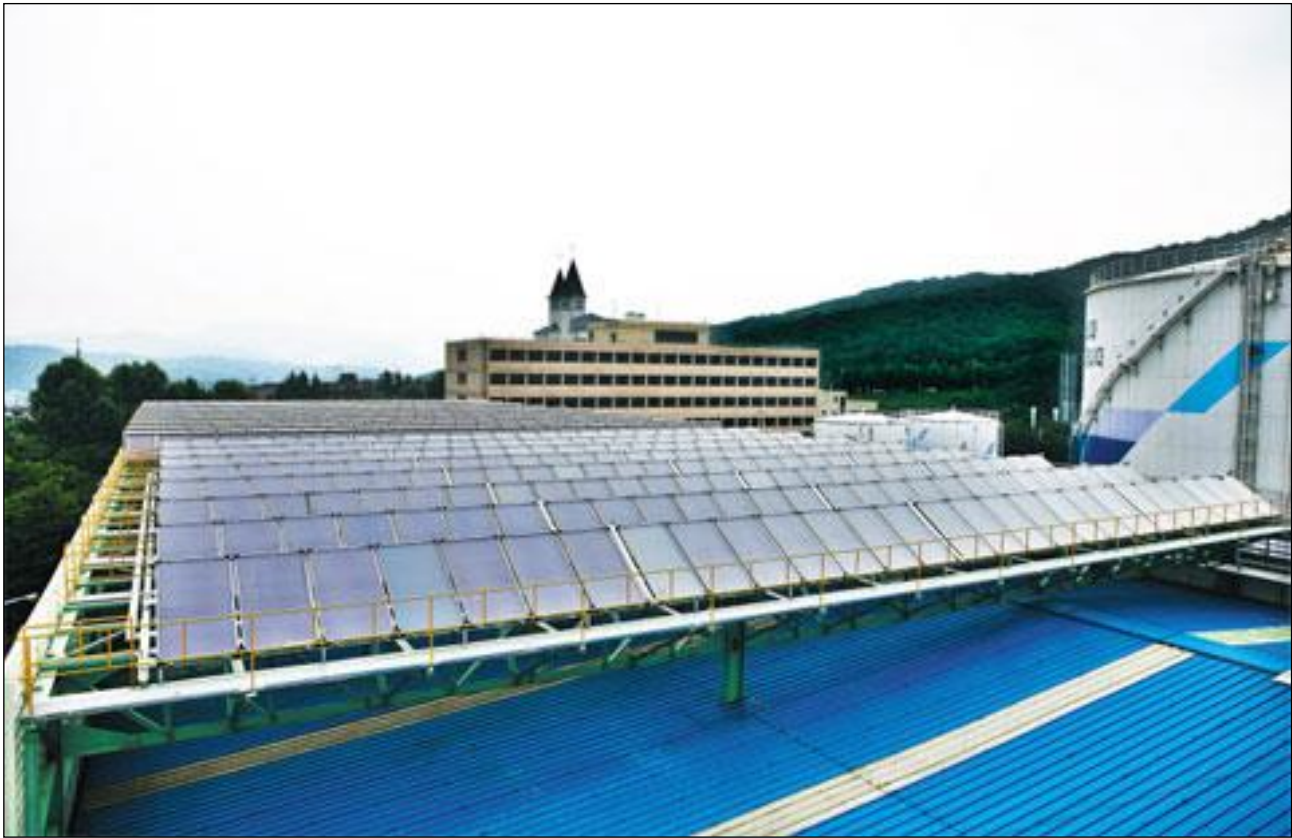
Abbildung 20: Solarthermieanlage des KDHC Bundang
