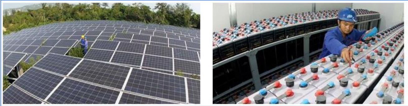
Abbildung 35: Microgrid auf der Insel Dangao
