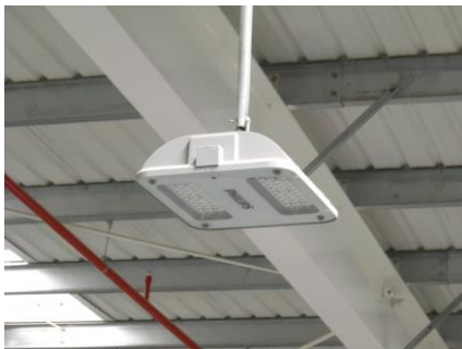
LED-Lampe in der Produktionshalle von Schmalz India (Quelle: AHK Indien 2017)
