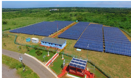
Abbildung 10: Beispiel Fotovoltaikpark „La Habana“ 67
