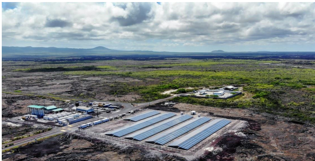
Abbildung 13 Erneuerbare Energien Galapagos, Quelle: Siemens- Erneuerbare Energien Galapagos
