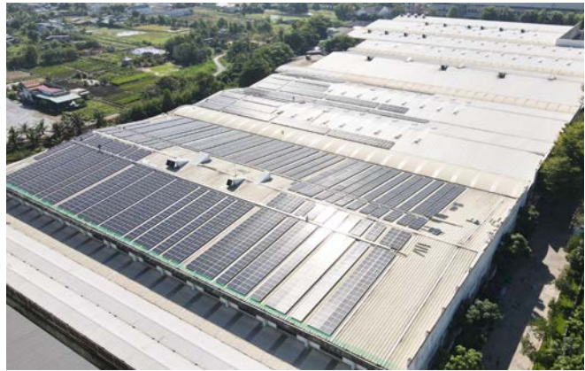
1-MWp-Anlage bei Jia Hsin Company Limited, Vietnam
