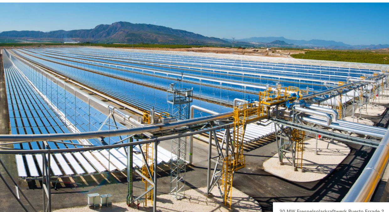
30 MW Fresnelsolkraftwerk Puerto Errade 2, Calasparra, Spanien (FRENELL GMBH)
