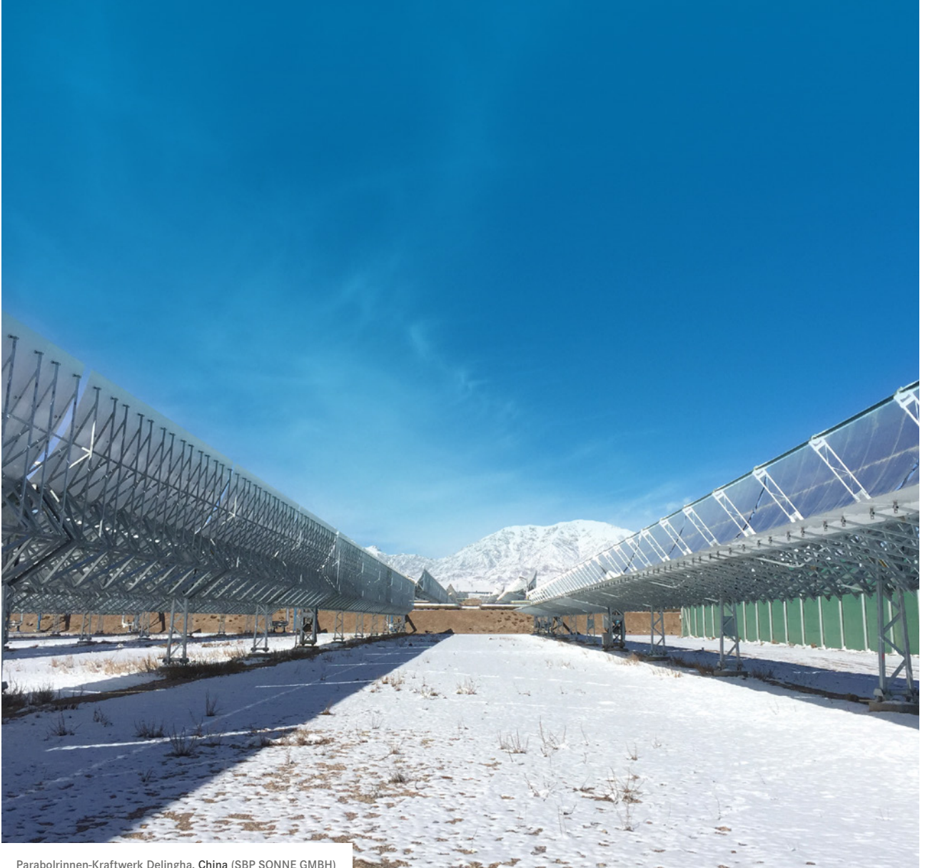
Parabolrinnen-Kraftwerk Delingha, China (SBP SONNE GMBH)
