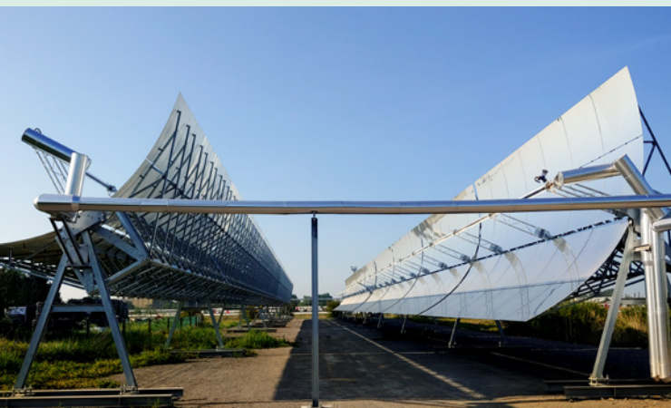
Prozesswärme für die chemische Industrie in Oostende, Belgien (SOLARLITE CSP TECHNOLOGY GMBH)
