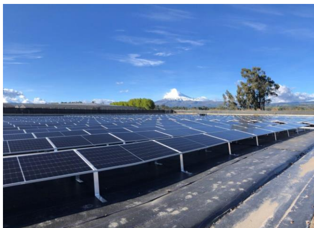
Abbildung 11: PV-Anlage des Unternehmens Provefrut, Foto: Provefrut
