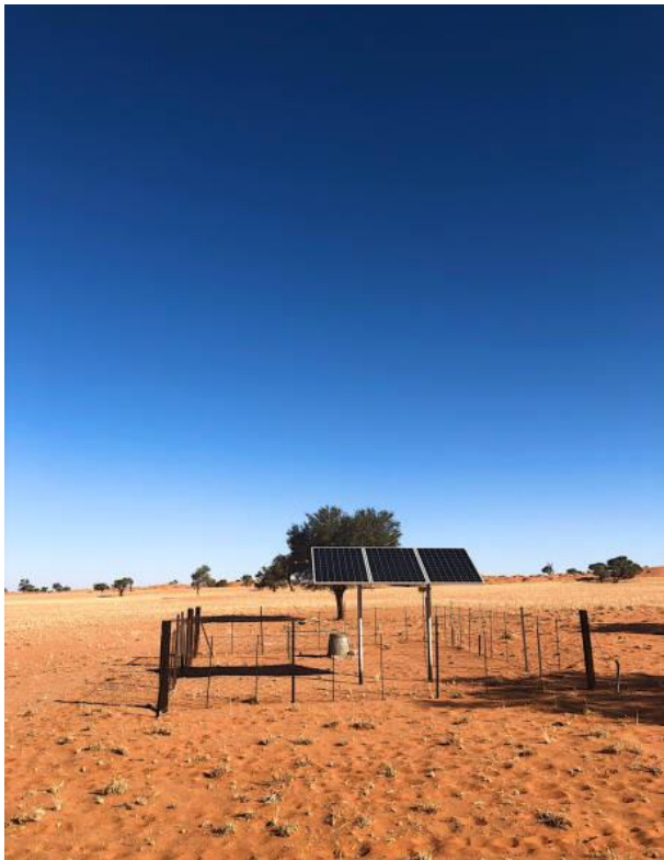
Abbildung 11: Wasserpumpe am Projektstandort
