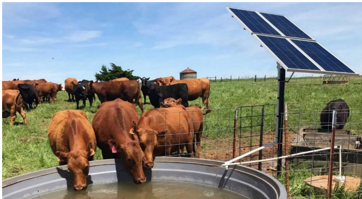
Abbildung 5: Solare Wasserpumpe für die Viehhaltung
