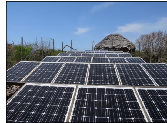
PV Hybridsystem einer Off-Grid Lodge
