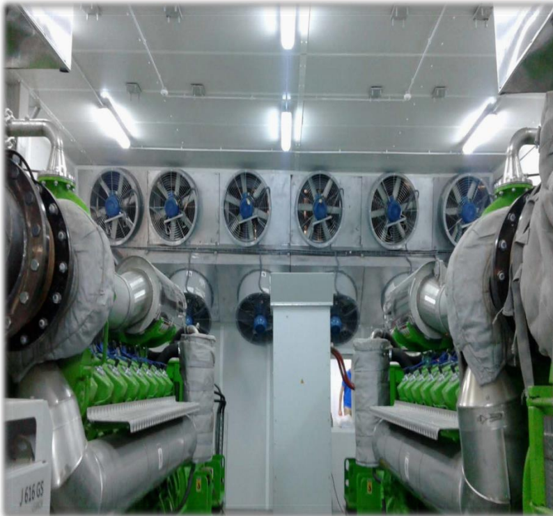
2 Moteurs du système de cogénération
