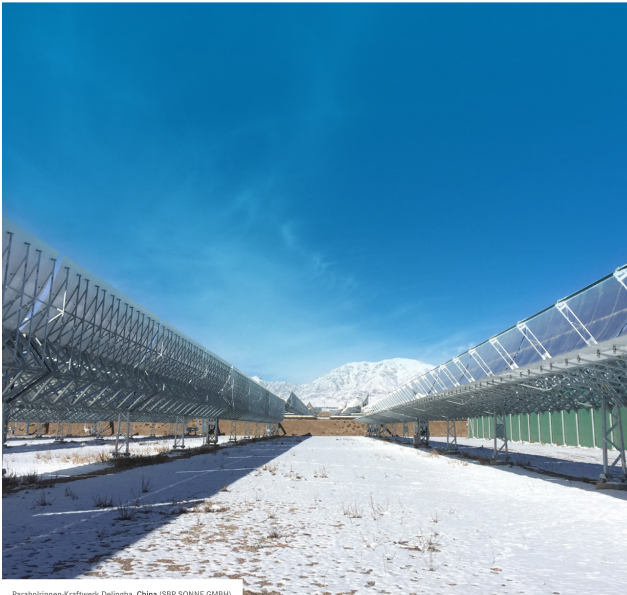
Parabolrinnen-Kraftwerk Delingha, China (SBP SONNE GMBH)
