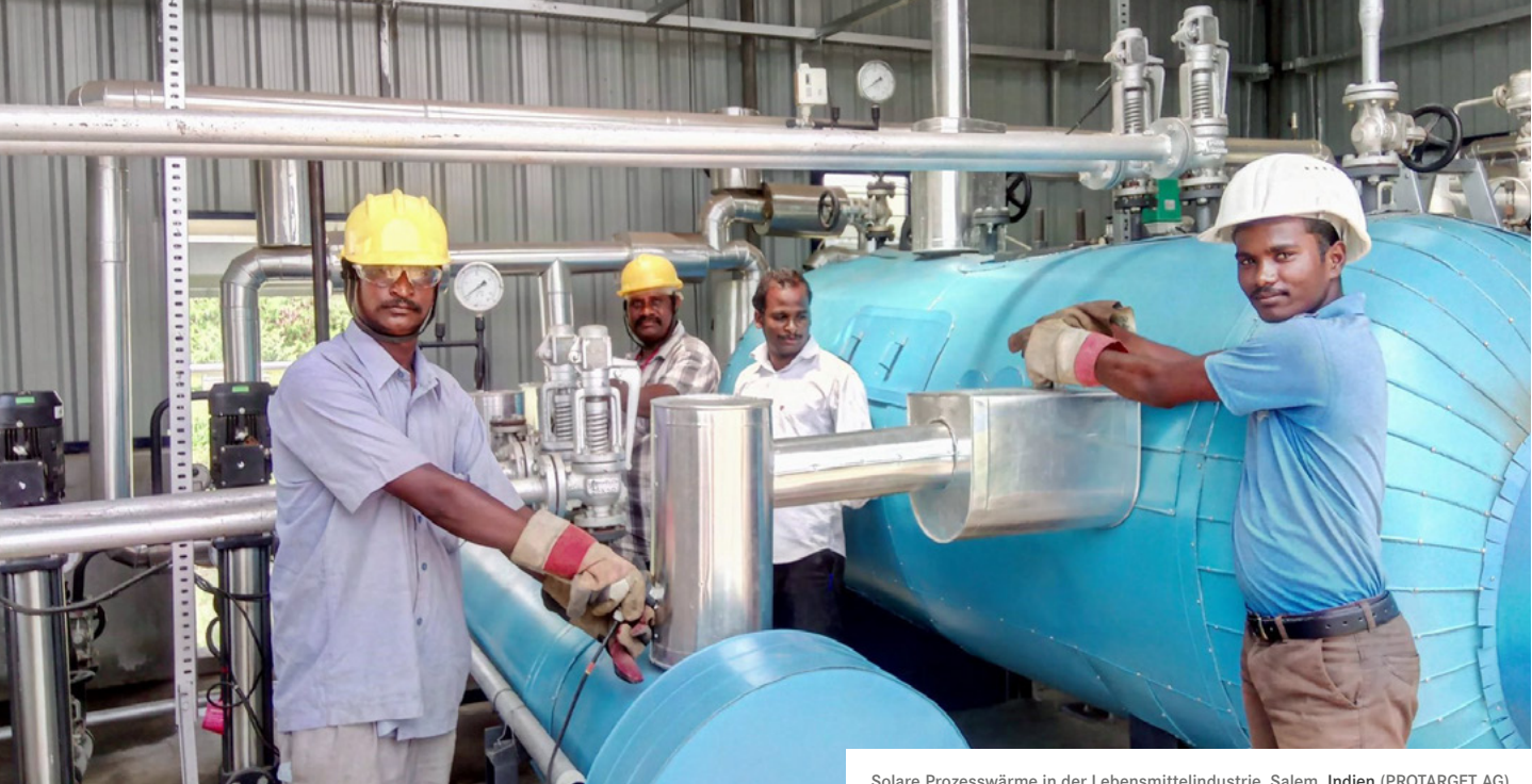
Solare Prozesswärme in der Lebensmittelindustrie, Salem, Indien (PROTARGET AG)
