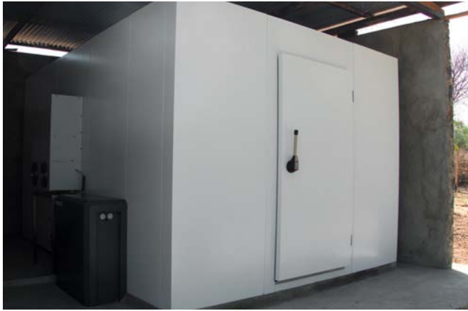
Kühlraum und Kühlaggregat Cold storage room and refrigeration unit
